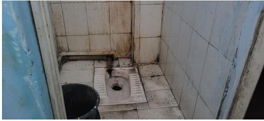
Nc- Unhygienic Washroom.jpg
