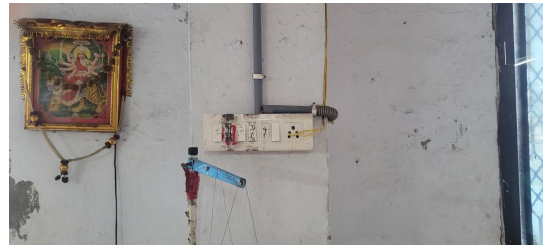
Nc- Loose wires (2).jpg
