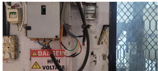
Nc- Loose wires.jpg
